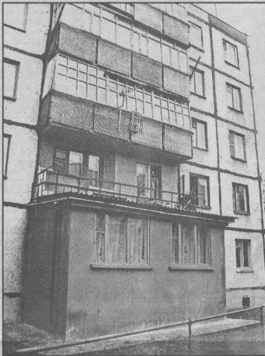
Заны приборы отопления, что существенно повлияло на работу всей системы и на общий температурный режим дома.
