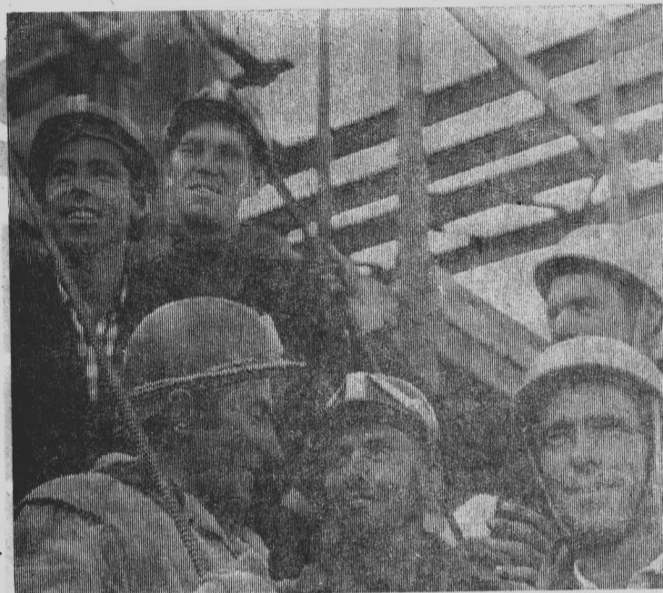
Бригада плотников-бетонщиков Николая Грушина приступила к бетонированию фундамента под второй турбогенератор на пуско-резервной ТЭЦ.
